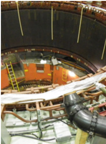
Un des 11 groupes turbine-alternateur de la centrale hydroélectrique de Churchill Falls. Martin Lopatka, Creative Commons
